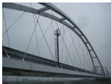
淀川橋梁風速計
