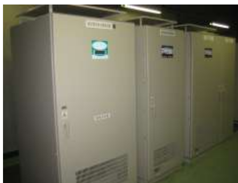
直流電源装置
